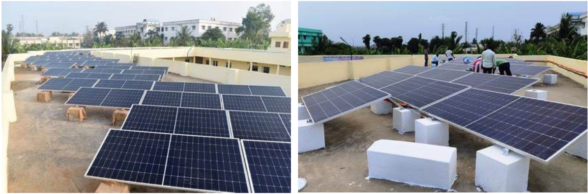
Solar op het hele dak van de school
