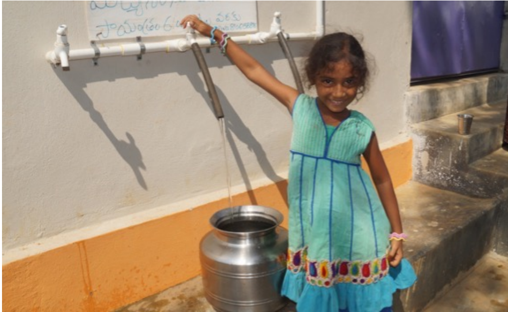
Waterzuiveringsinstallaties in 15 vissersdorpen
